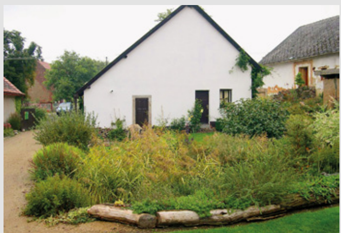
Kořenová čistírna odpadních vod u rodinného domu. V štěrku zaplaveném odpadními vodami rostou mokřadní rostliny (orobinec, chrastice, rákos, kosatec). Na jejich kořenech žijí bakterie, které rozkládají nečistoty v odpadních vodách a vodu tak čistí (Jan Vymazal)
